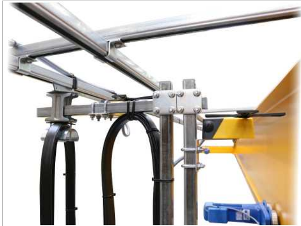
Interruptor de cruceta como interruptor fin de carrera del carro
